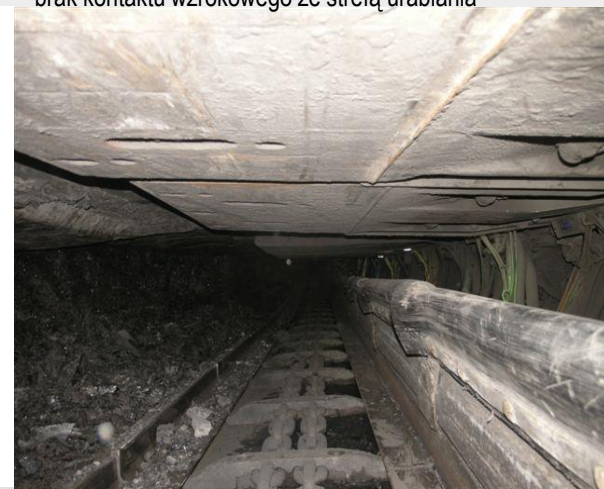
Fot. 2. Ściana strugowa, przedział urabiania. Wypadnięty fragment stropu i obsypany ocios.
